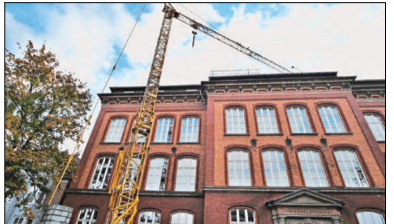
Ein Fachfirma aus der Region kümmert sich um die Dacharbeiten. Dort wird ein Zugang zum vergrößerten Aufzugschacht gebaut.
